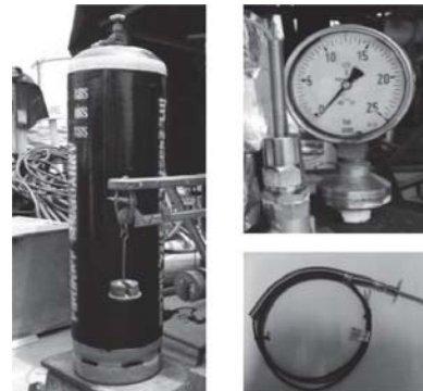
รูปที่ 6 ถังเก็บแอมโมเนียบริสุทธิ์ หัววัดอุณหภูมิและ Pressure gauge
